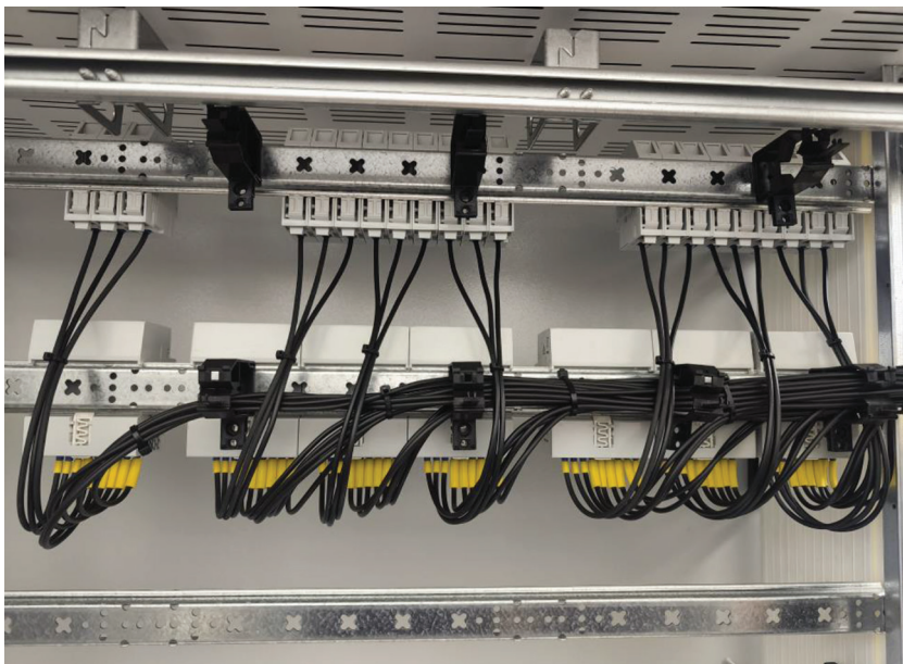
Fot. 2. Przykład ułożenia w powietrzu i wiązkach (zdjęcie wykonane od strony „pleców” rozdzielnic)
