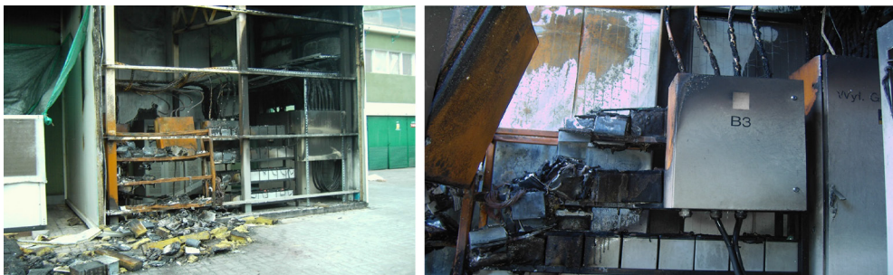
Foto 1. Pomieszczenie bateryjne zasilacza UPS po wybuchu wodoru
