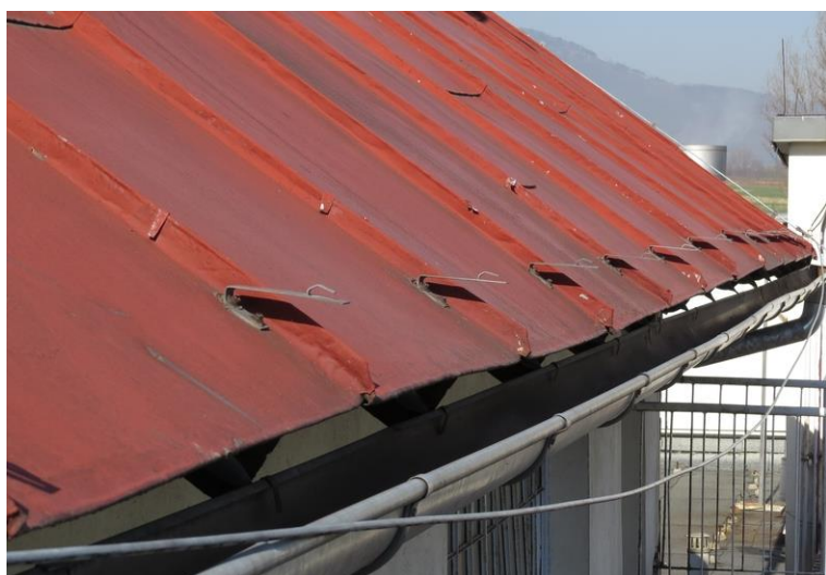
Fot1. Przykład niewłaściwie wykonanego układu zwodów na spadzistym dachu budynku - śnieg spowodował wyrwanie drutu z uchwytów
