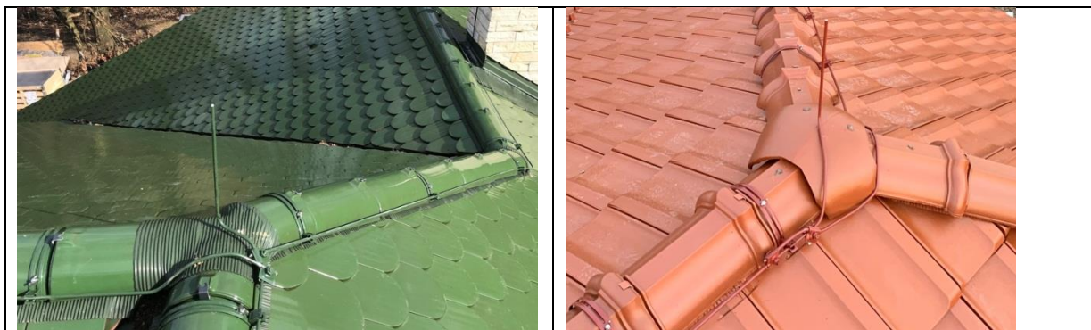
Fot.5. Przykłady siatki zwodów na dachu budynku dopasowane kolorystycznie do koloru pokrycia dachowego
