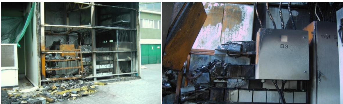
Fot. 1: Pomieszczenie bateryjne zasilacza UPS po wybuchu wodoru spowodowane prądem zwarcioveymi
