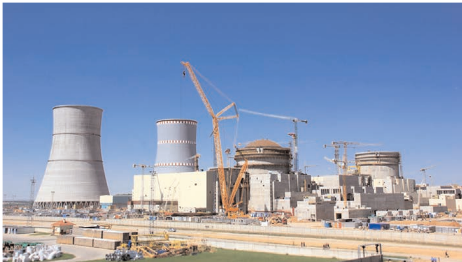
Rys. 2. Budowa elektrowni w Ostrowcu w zaawansowanej fazie. Widoczne są oba budynki reaktorów. Blok 1 ma już z zamkniętą od góry kopułę obudowy bezpieczeństwa [fot. Białoruska Elektrownia Jądrowa].
